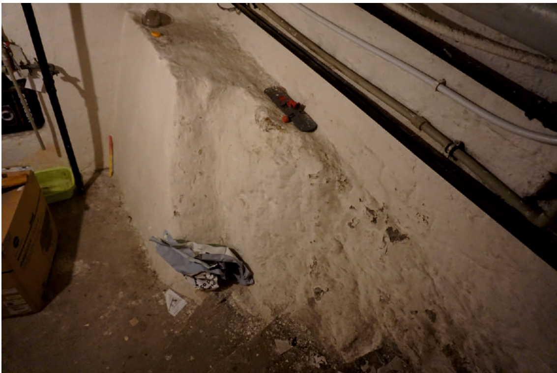
Fot. 52 Relikt kamiennego fundamentowania kontr wału dawnej fosy zamkowej, wskazany do oczyszczenia i ekspozycji.
