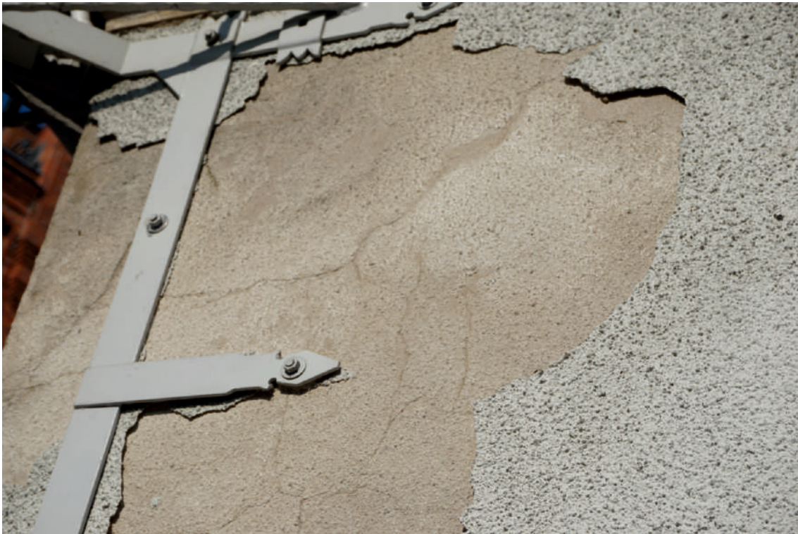
Fot. 31 Elewacja zach. Spękanie i rozwarstwienie tynków. Liczne mikrospeknięcia.
