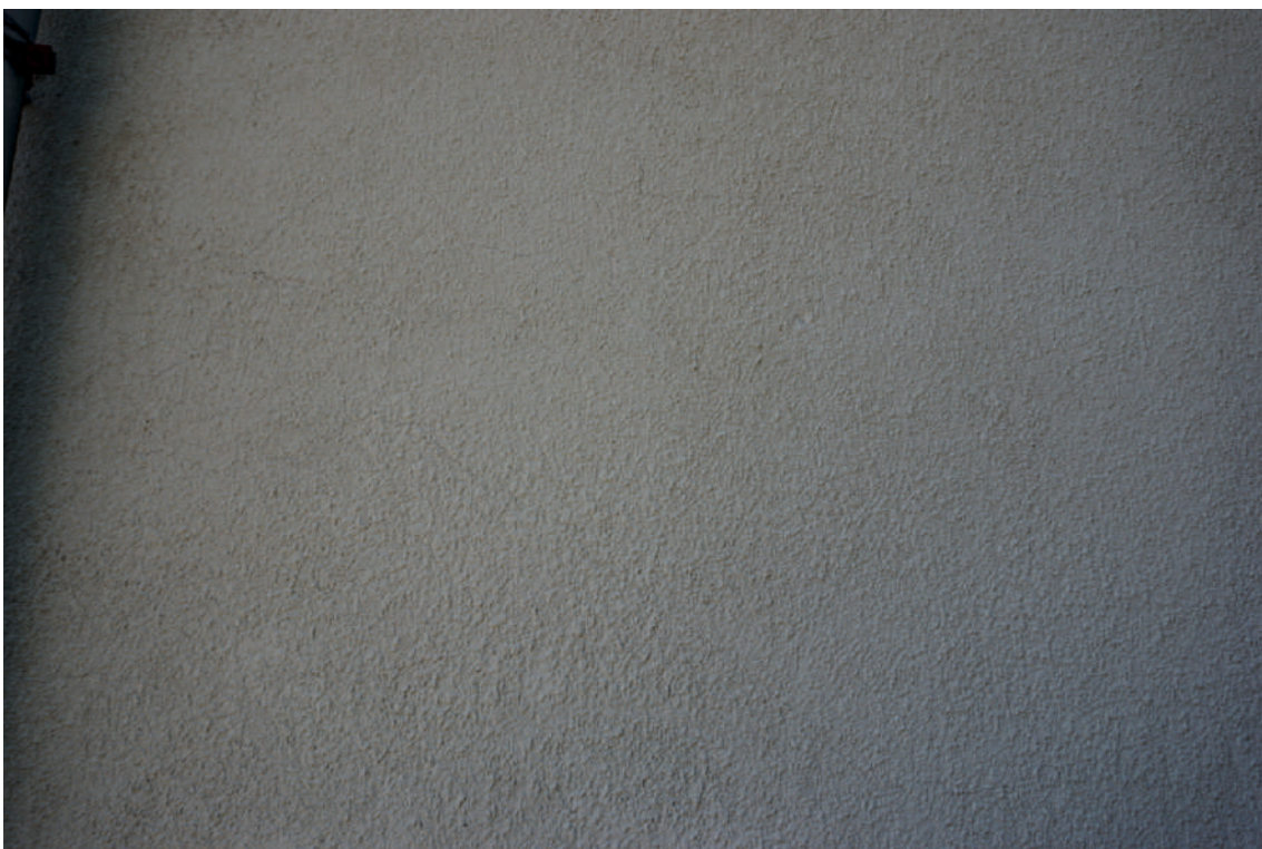
Fot. 34 Elewacja wsch. Siatka mikrospękań.
