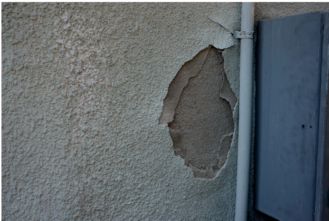
Fot. 27 Elewacja wsch. Odspojenie i rozwarstwienie tynków.
