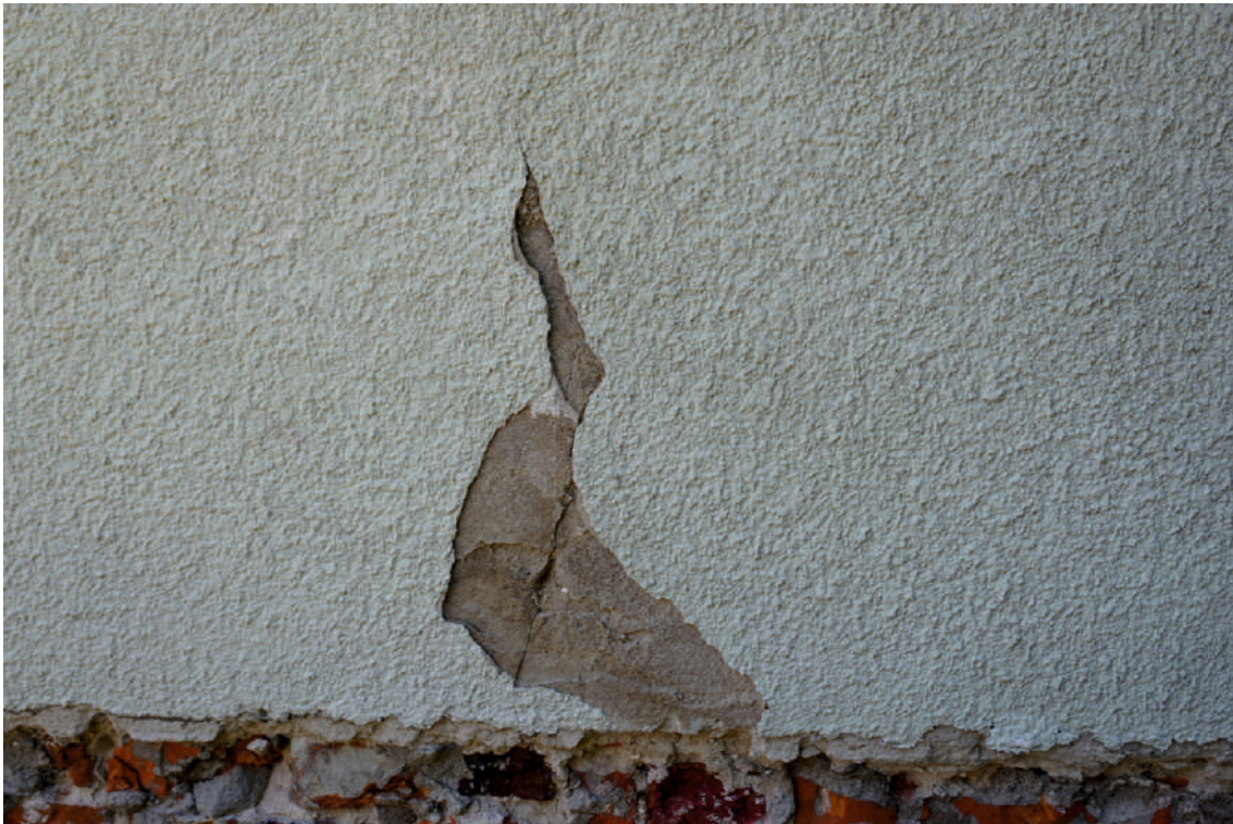
Fot. 29 Elewacja pd. Spękanie i rozwarstwienie tynków.
