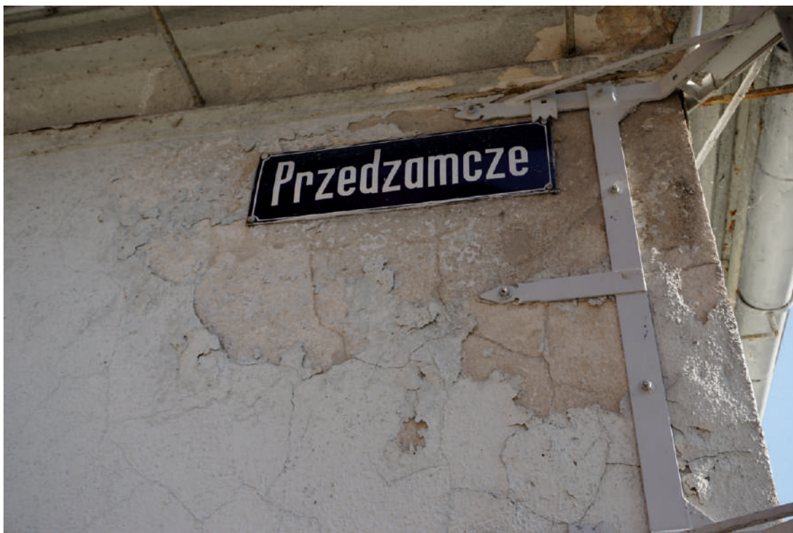
Fot. 32 Elewacja pn. Spękanie i rozwarstwienie tynków. Liczne mikrospeknięcia.
