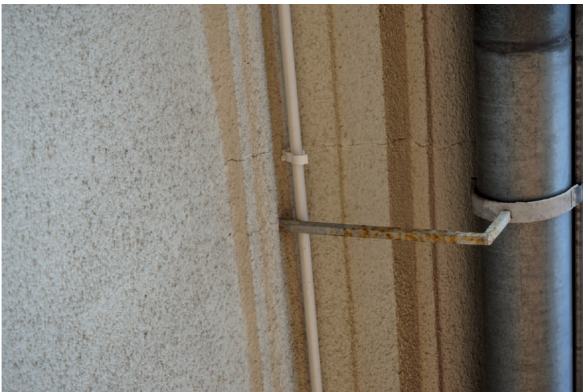
Fot. 36 Elewacja pd. Przykład pęknięcia gzymsu koronującego.
