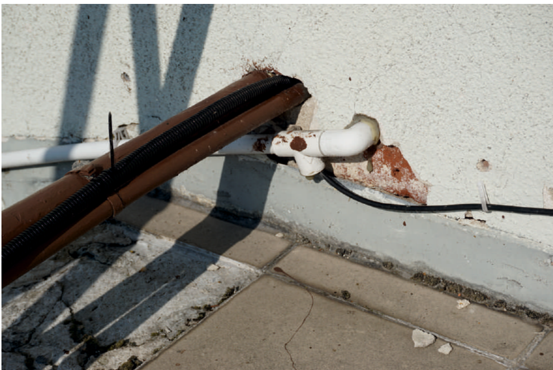
Fot. 42 Taras. Rozszczelnienie wykończenia izolacji tarasu. Przewody kładzione natynkowa.
