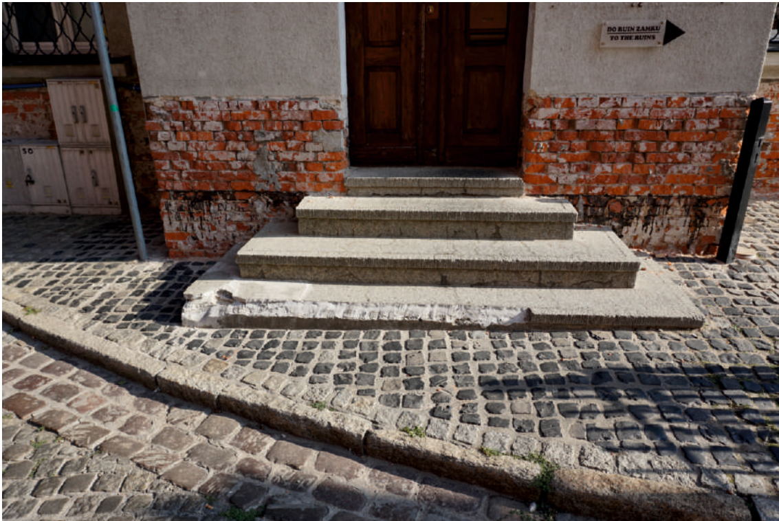
Fot. 45 Zdestruowane schody z lastriko przed głównym wejściem.
