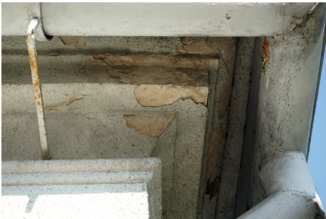
Fot. 38 Naroże pd.-zach. przybudówki. Destrukcja gzymsu koronującego.
