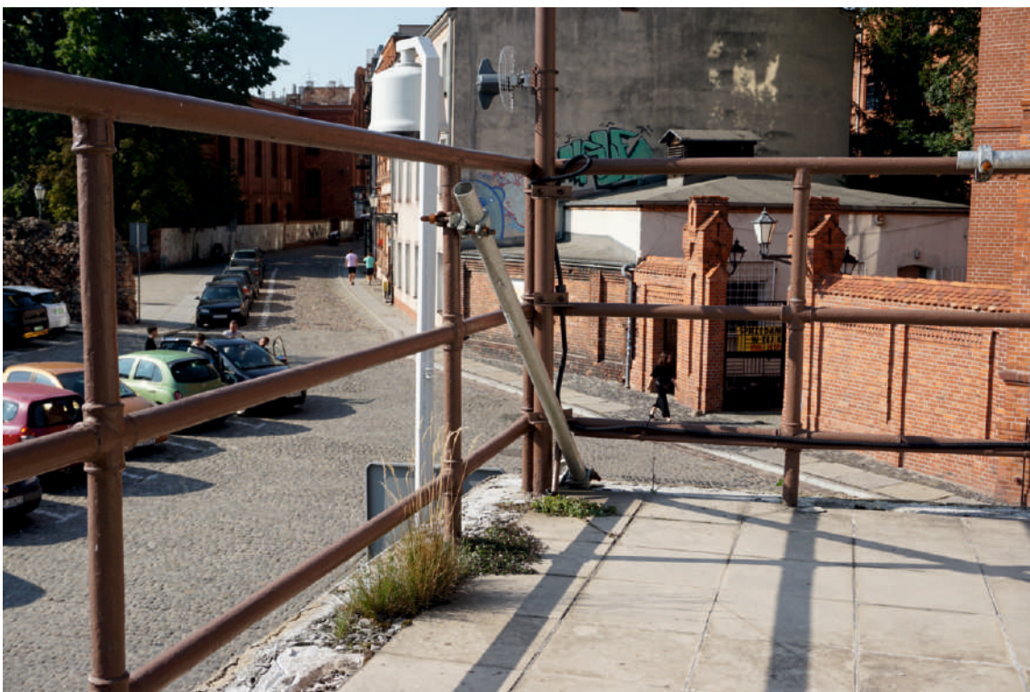
Fot. 40 Taras. Destrukcja posadzki ceramicznej i korony muru.
