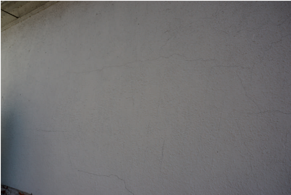
Fot. 33 Elewacja zach. Siatka mikrospękań.
