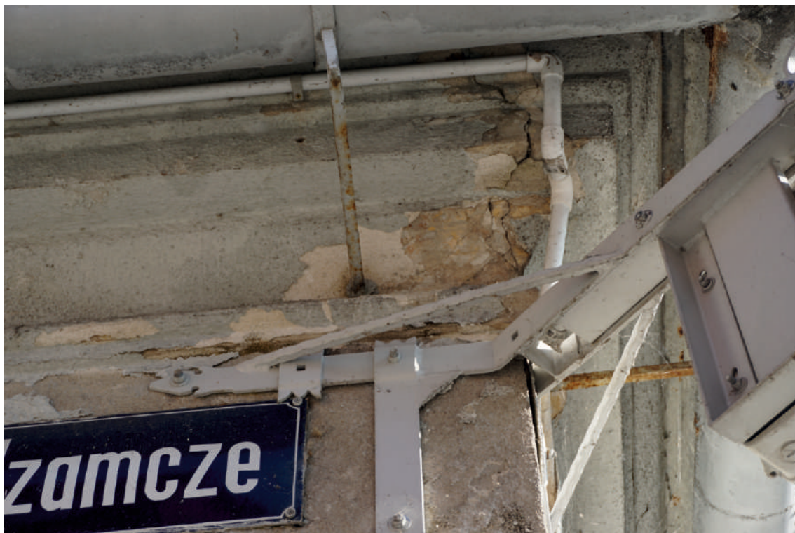
Fot. 37 Naroże pn.-zach. przybudówki. Destrukcja gzymsu koronującego.
