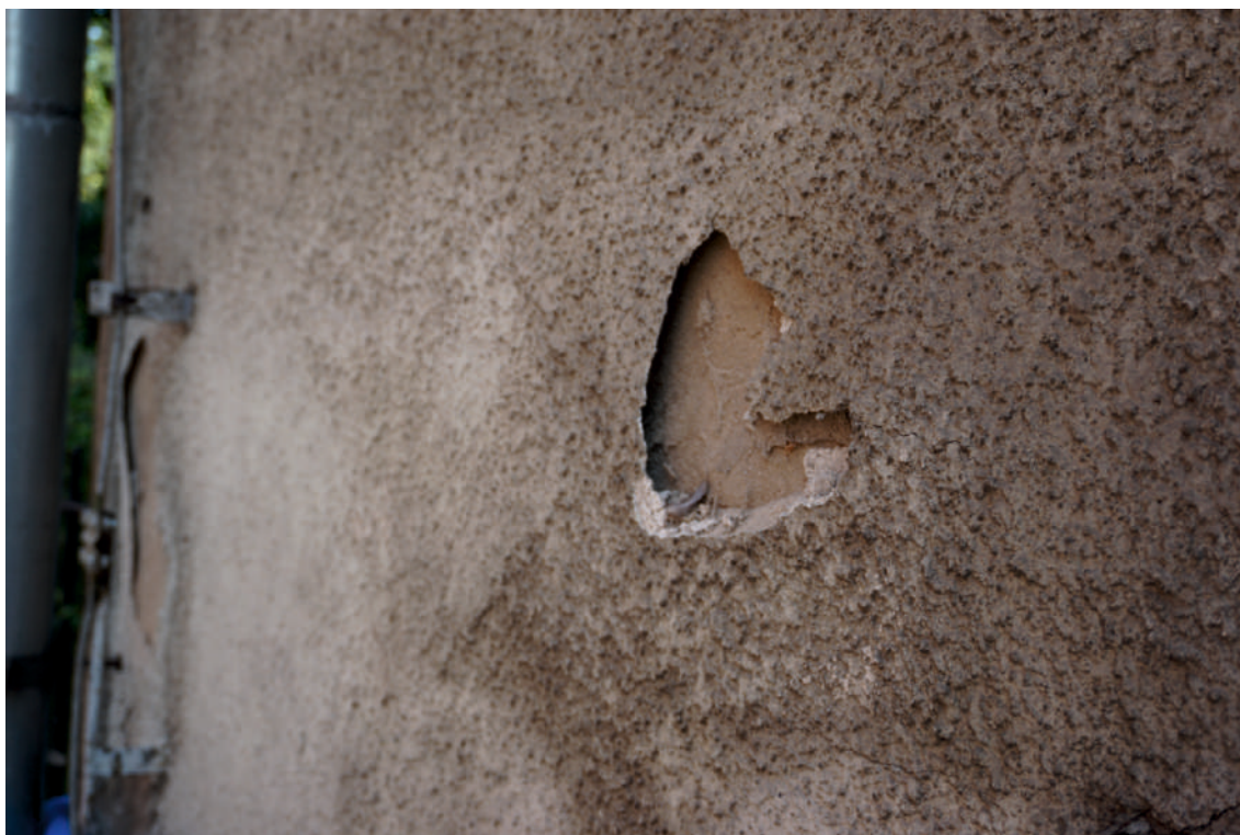
Fot. 28 Elewacja pn. Odspojenie i rozwarstwienie tynków.
