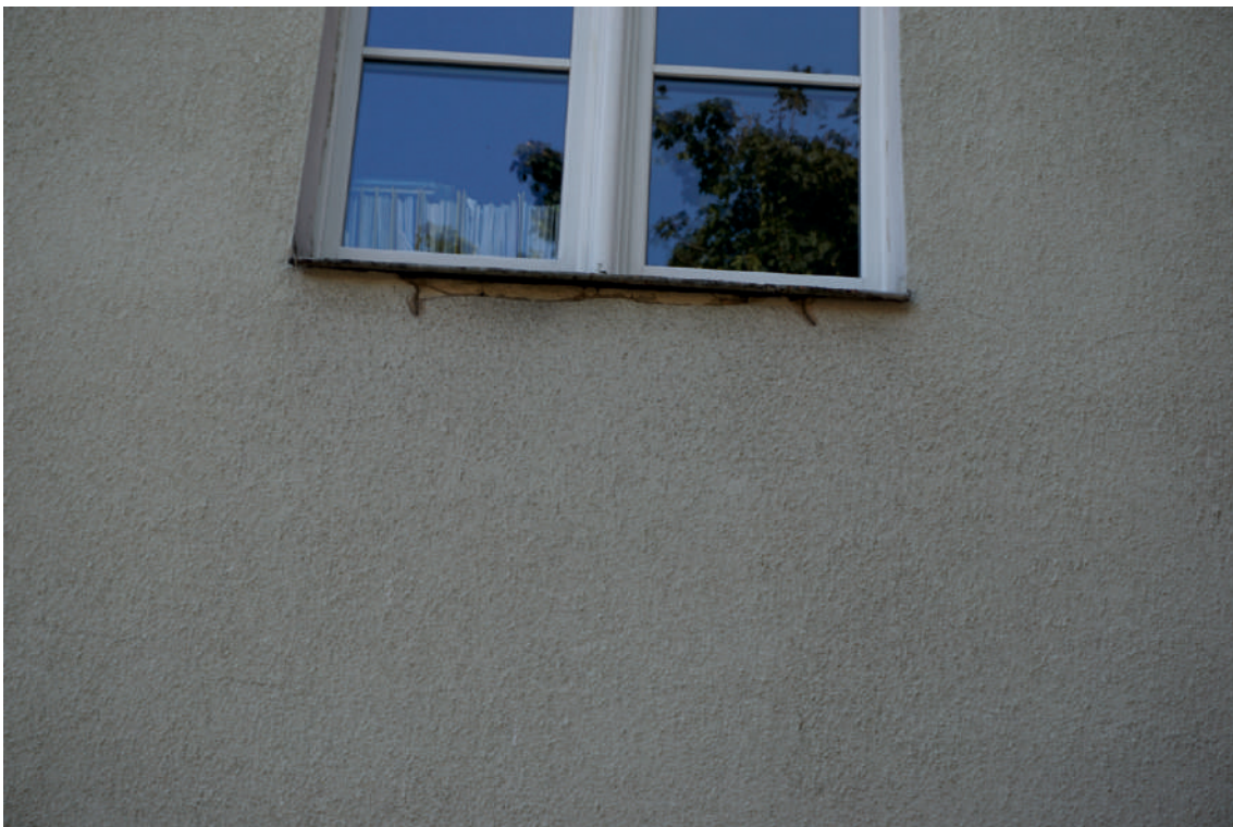
Fot. 30 Elewacja wsch. Spękanie i rozwarstwienie tynków.
