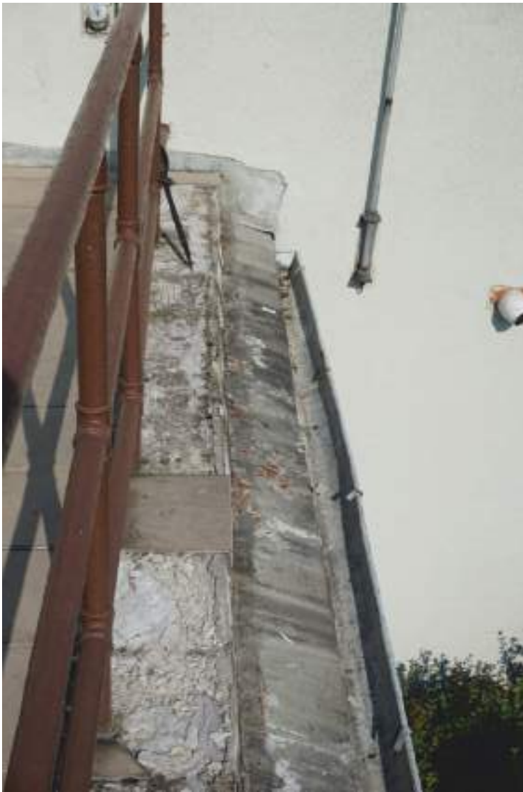
Fot. 41 Taras. Destrukcja posadzki ceramicznej i warstw izolacyjnych na koronie muru.
