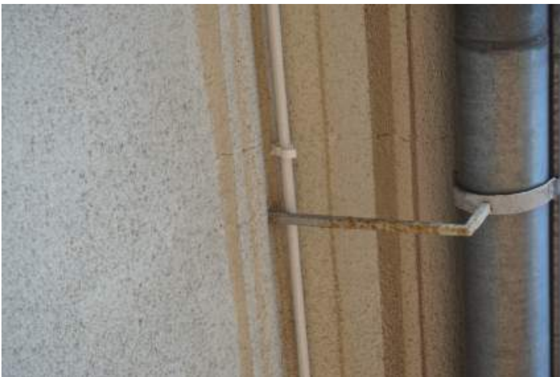
Fot. 36 Elewacja pd. Przykład pęknięcia gzymsu koronującego.
