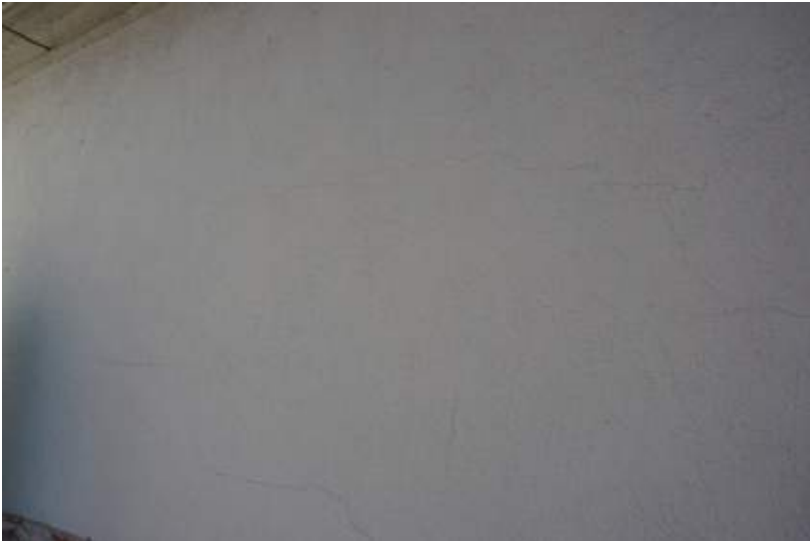
Fot. 33 Elewacja zach. Siatka mikrospękań.
