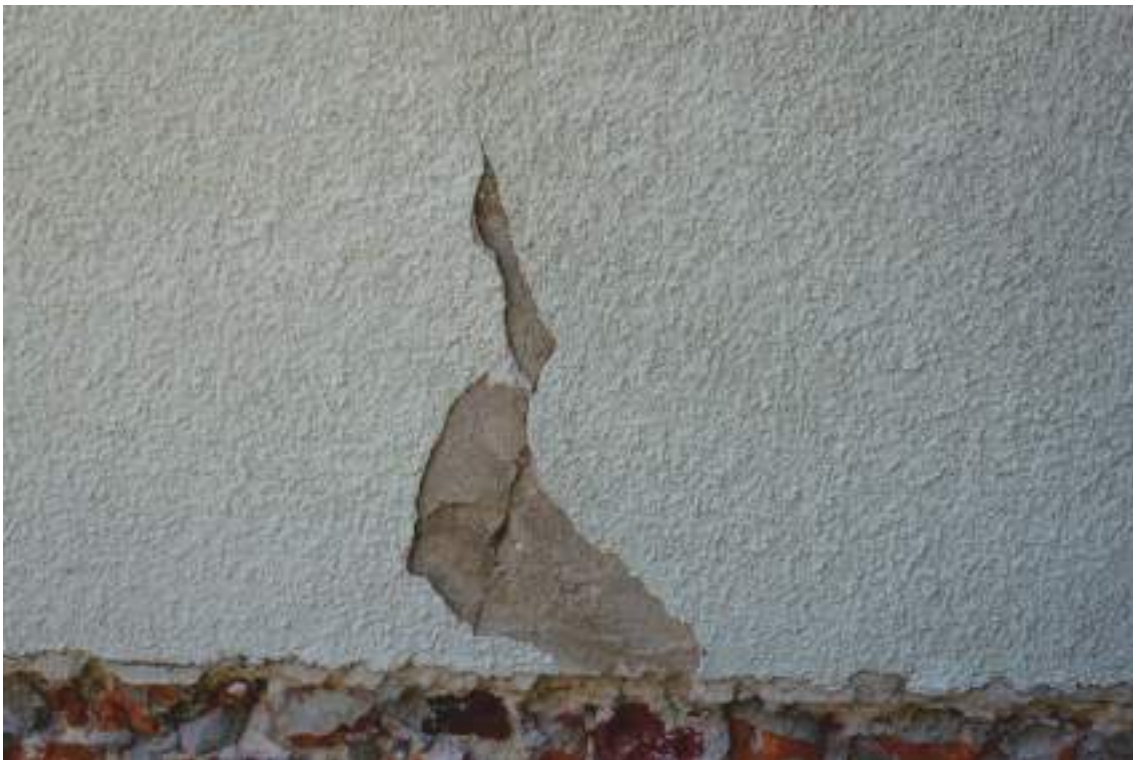
Fot. 29 Elewacja pd. Spękanie i rozwarstwienie tynków.
