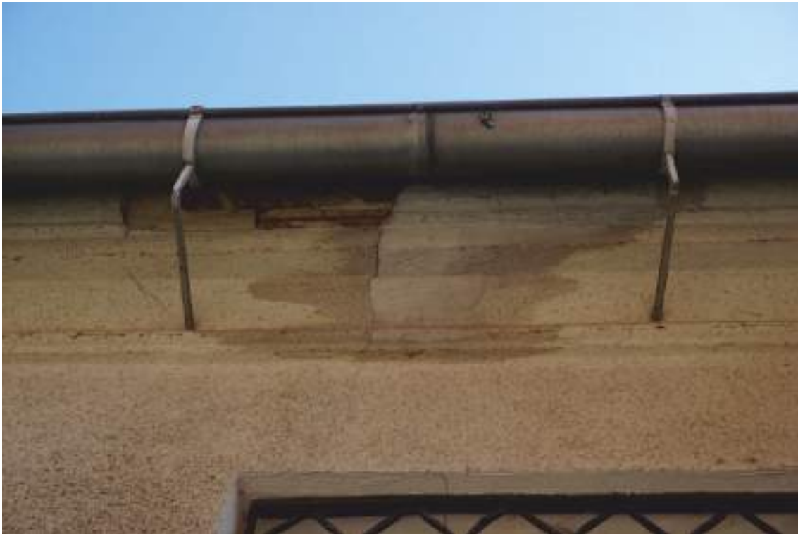
Fot. 35 Elewacja pn. Spękania i ubytki gzymsu koronującego.
