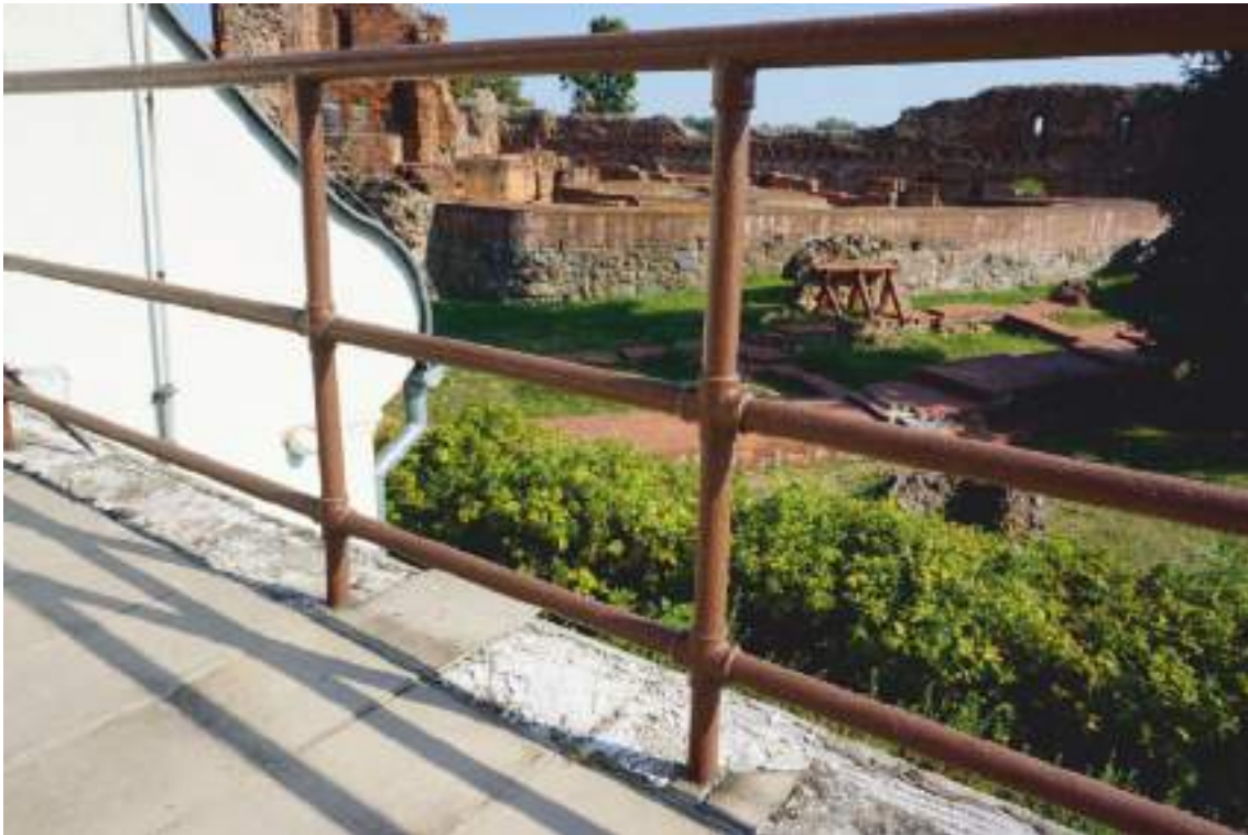
Fot. 44 Taras. Metalowa balustrada z produktami korozji zamalowanymi farbą.
