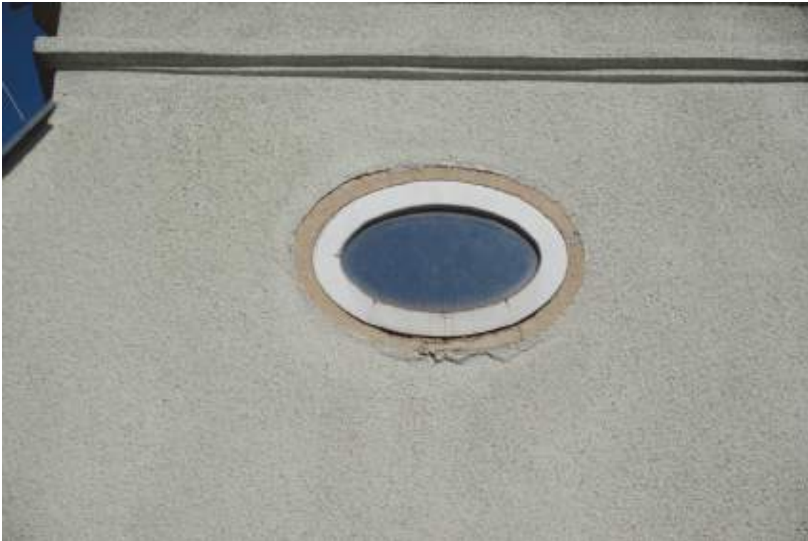
Fot. 47 Pomniejszony otwór okienny w zwieńczeniu zachodniego szczytu, wypełniony współczesną, wadliwie zrekonstruowaną stolarką.
