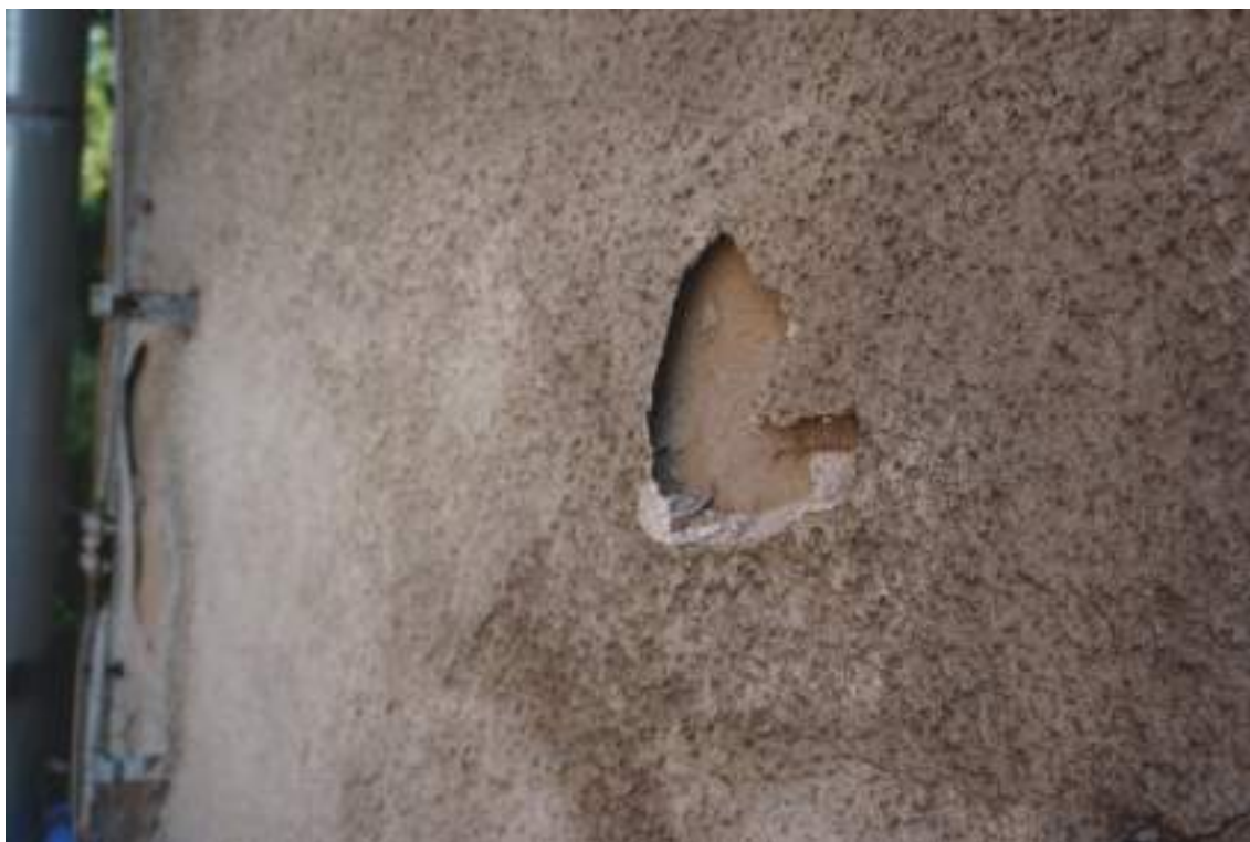
Fot. 28 Elewacja pn. Odspojenie i rozwarstwienie tynków.
