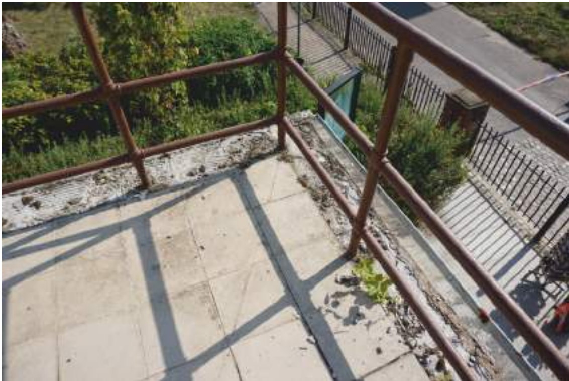
Fot. 39 Taras. Destrukcja posadzki ceramicznej i korony muru.
