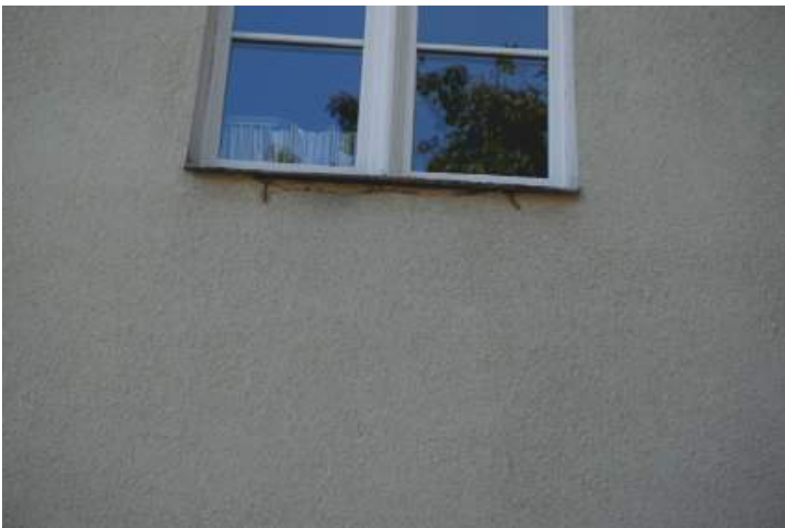
Fot. 30 Elewacja wsch. Spękanie i rozwarstwienie tynków.
