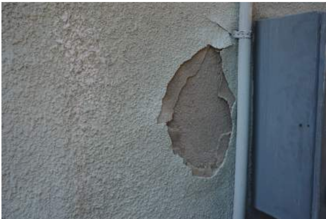
Fot. 27 Elewacja wsch. Odspojenie i rozwarstwienie tynków.
