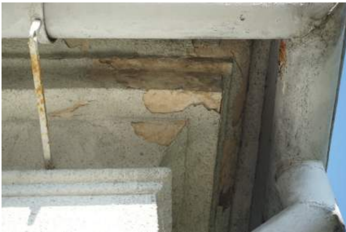
Fot. 38 Naroże pd.-zach. przybudówki. Destrukcja gzymsu koronującego.
