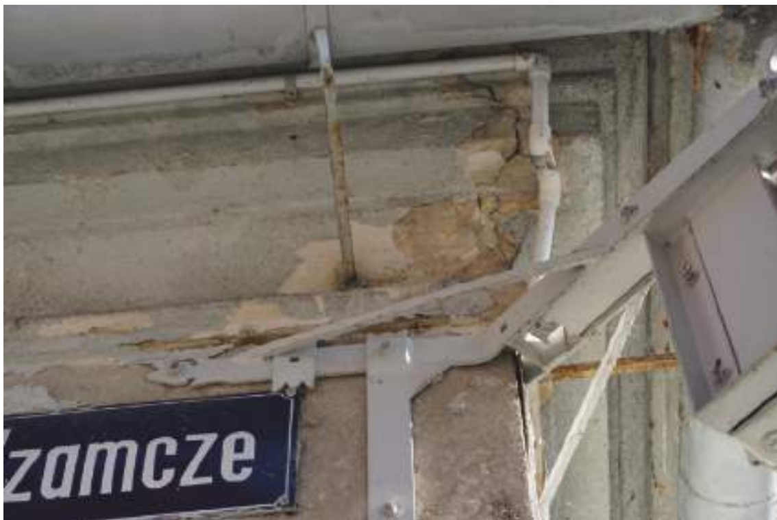
Fot. 37 Naroże pn.-zach. przybudówki. Destrukcja gzymsu koronującego.
