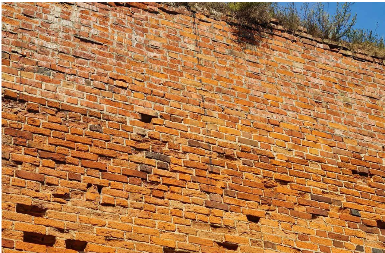
98. Zamek Dybowski. Zniszczenia cegły w obrębie lica murów. Widoczne białe wykwyty będące skutkiem wypłukiwania rozpuszczonych w wodzie składników zapraw oraz zalanie smołą z miejsca układania warstwy papy jako izolacji poziomej korony murów. Stan w sierpniu 2022 r. (Fot. E. Płocińska)
