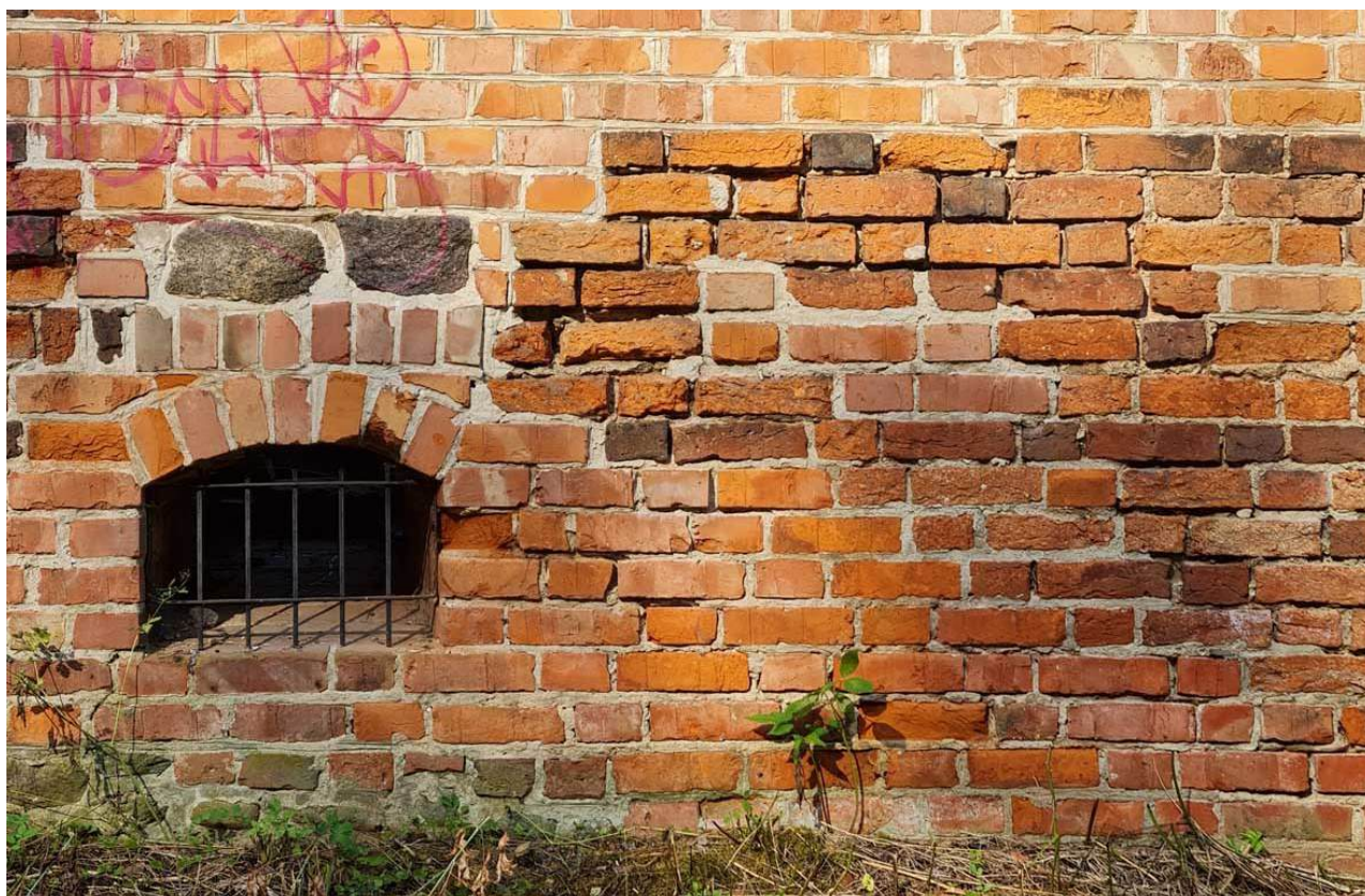
105. Zamek Dybowski. Zniszczenia cegły historycznej i współczesnej. Niewłaściwe cegły i spoiny użyte do przemurowań. Stan w sierpniu 2022 r. (Fot. E. Płocińska)
