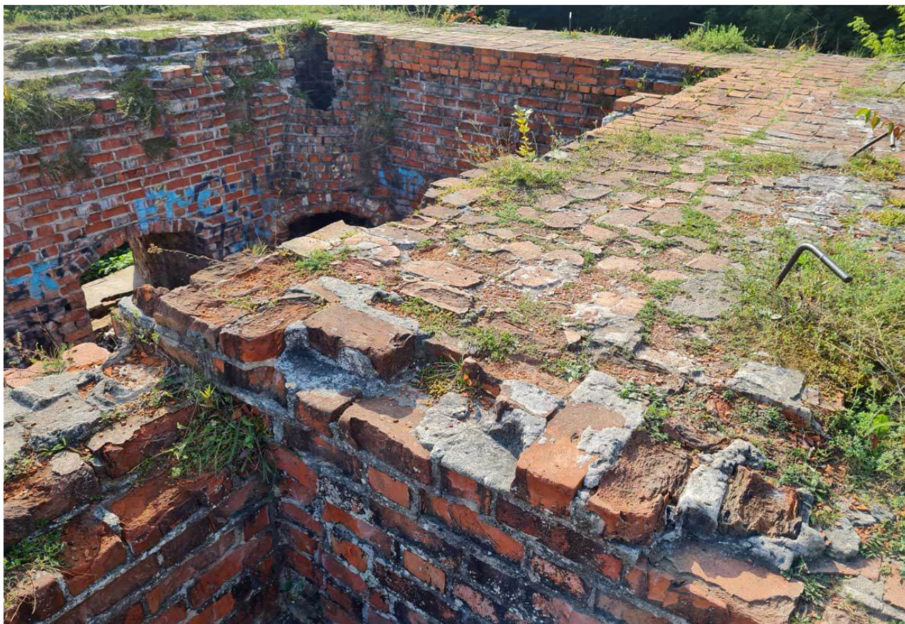
89. Zamek Dybowski. Stan zachowania korony murów. Sierpień 2022 r. (Fot. E. Płocińska)
