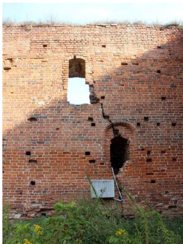
78. Zamek Dybowski. Północna ściana muru obwodowego dziedzica. Widoczna szczelina w murze. Stan w sierpniu 2022 r. (Fot. E. Płocińska)
