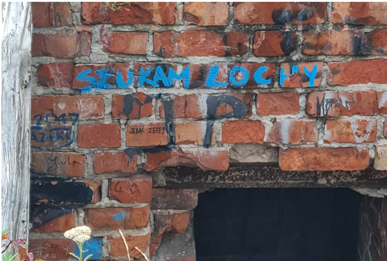
111. Zamek Dybowski. Zniszczenia lica ceglanego wskutek aktów wandalizmu. Stan w sierpniu 2022 r. (Fot. E. Płocińska)
