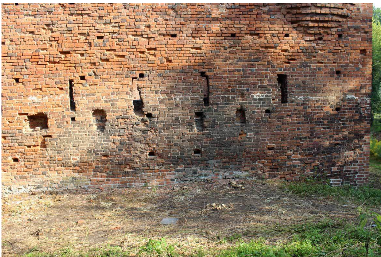
80. Zamek Dybowski. Wschodni odcinek muru południowego. Widoczna strefa podciągania kapilarnego wody z gruntu. Stan w sierpniu 2022 r. (Fot. E. Płocińska)
