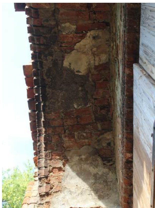
110. Zamek Dybowski. Zniszczenia tynków zabytkowych. Wieża bramna. Stan w sierpniu 2022 r. (Fot. E. Płocińska)
