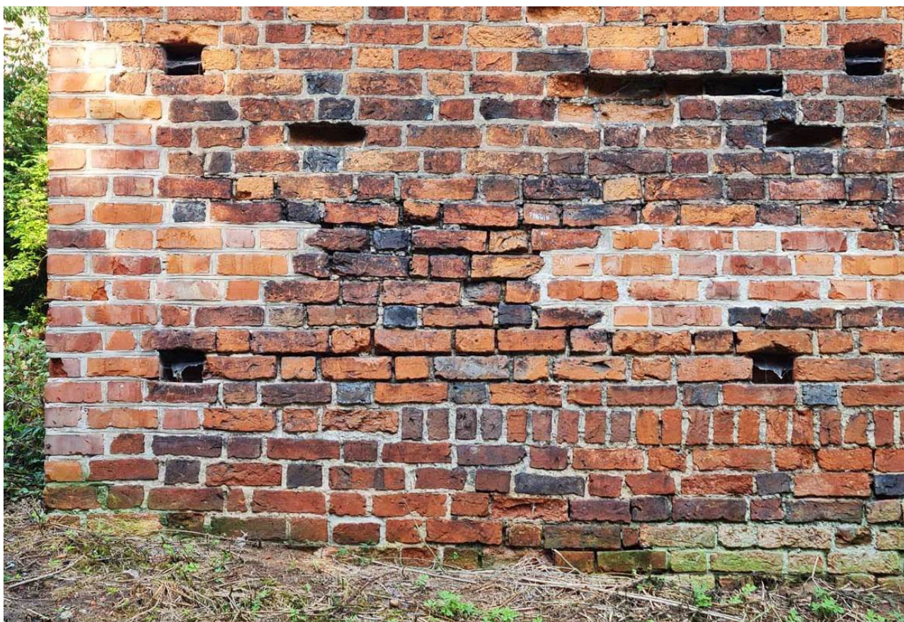
104. Zamek Dybowski. Zniszczenia cegły historycznej i współczesnej. Niewłaściwe cegły i spoiny użyte do przemurowań. Stan w sierpniu 2022 r. (Fot. E. Płocińska)
