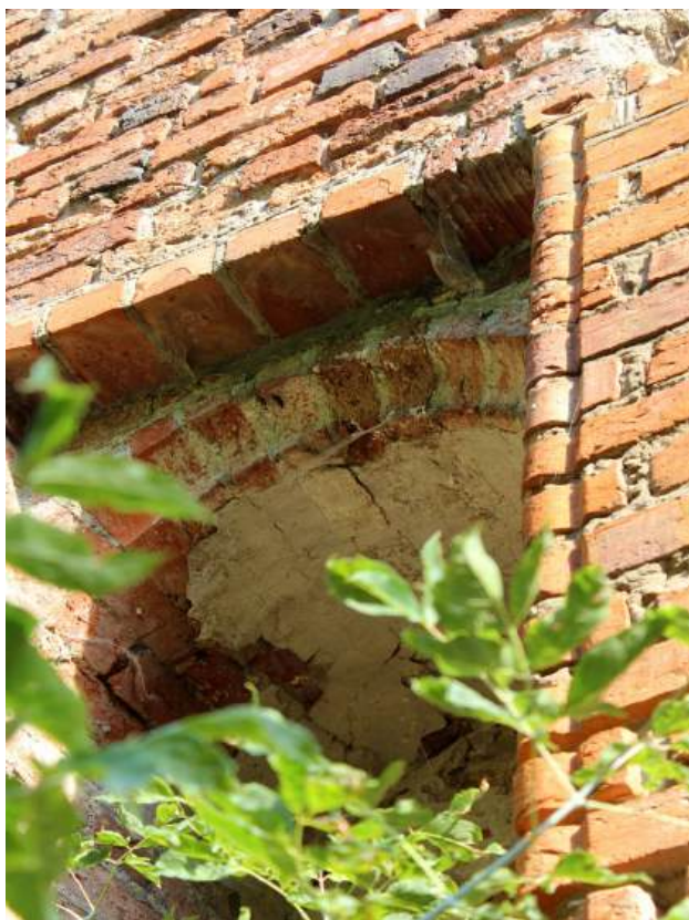
109. Zamek Dybowski. Zniszczenia tynków zabytkowych. Wieża bramna. Stan w sierpniu 2022 r. (Fot. E. Płocińska)
