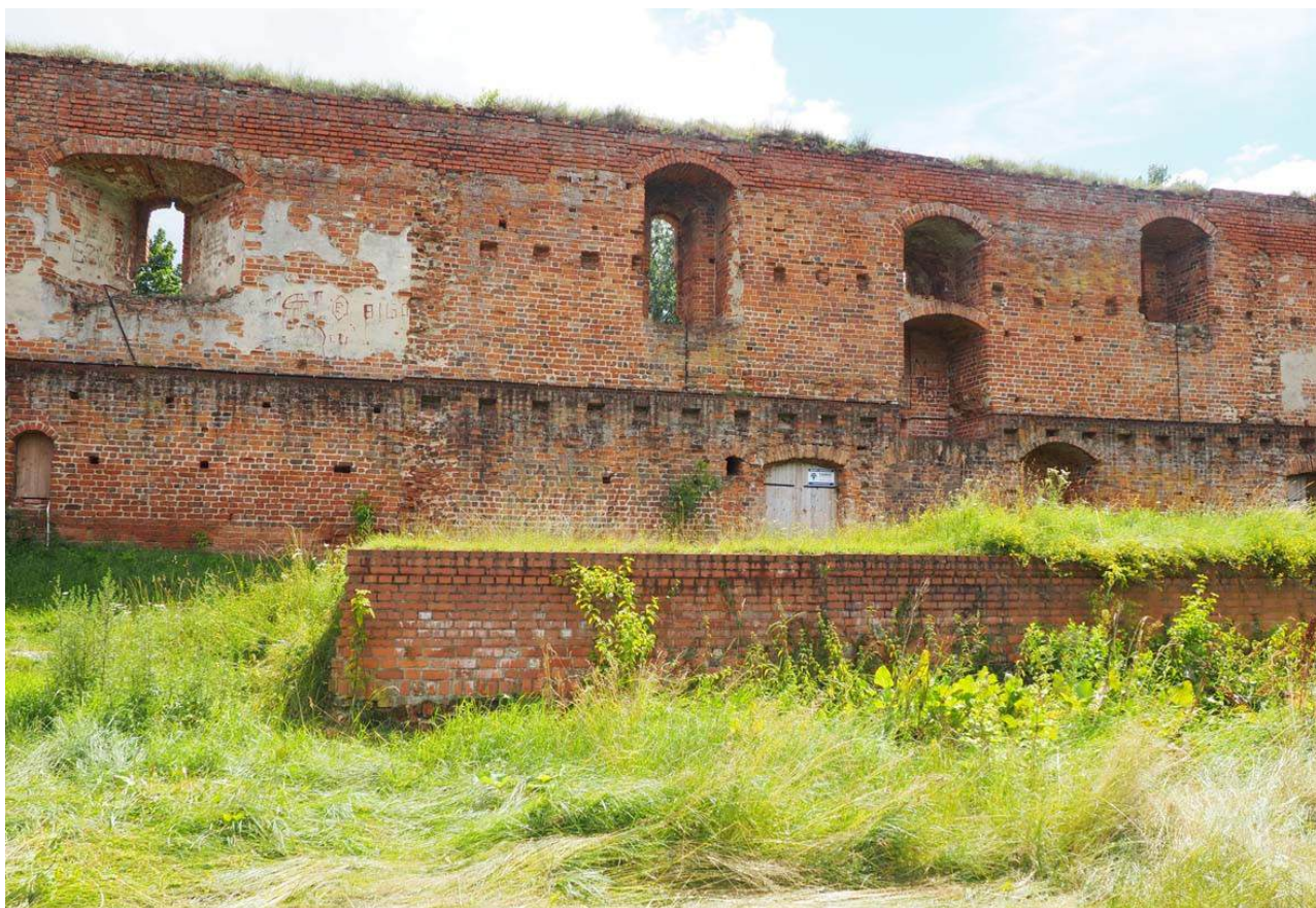
23. Zamek Dybowski. Relikty północnej ściany dawnego budynku mieszkalnego. Stan w sierpniu 2022 r. (Fot. P. Kołacz.)
