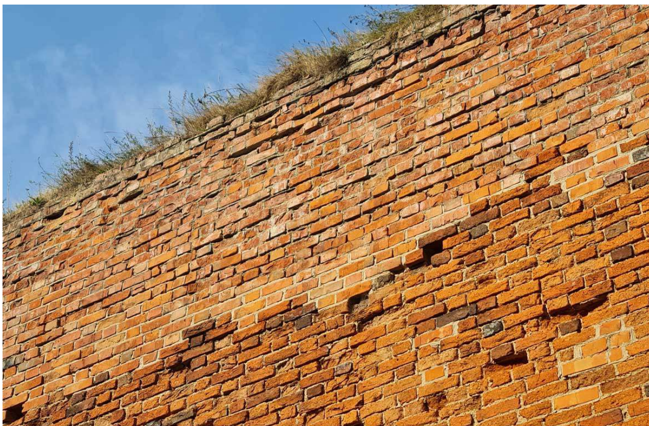
101. Zamek Dybowski. Zniszczenia cegły w obrębie lica murów. Widoczne białe wykwyty będące skutkiem wypłukiwania rozpuszczonych w wodzie składników zapraw. Destrukcja cegieł w partii korony i izolacji poziomej muru. Stan w sierpniu 2022 r. (Fot. E. Płocińska)
