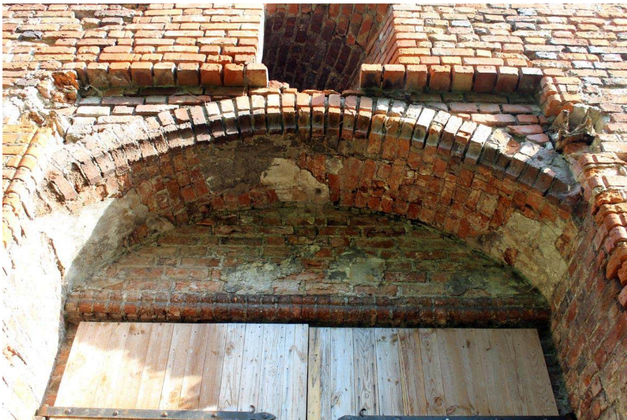
108. Zamek Dybowski. Zniszczenia tynków zabytkowych. Wieża bramna. Stan w sierpniu 2022 r. (Fot. E. Płocińska)
