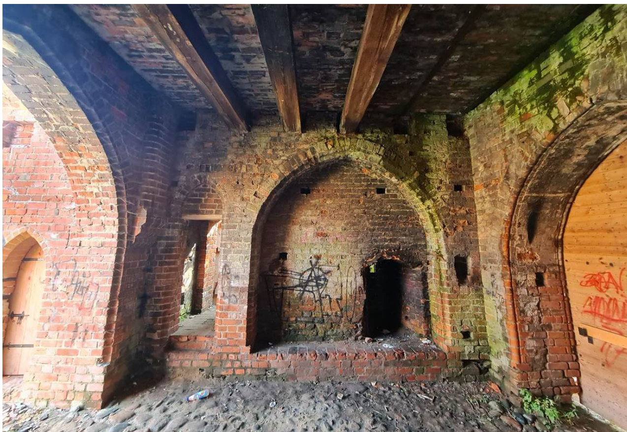
30. Zamek Dybowski. Przejazd wieży bramnej, ściana wschodnia. Częściowa rekonstrukcja. Stan w sierpniu 2022 r. (Fot. E. Płocińska.)
