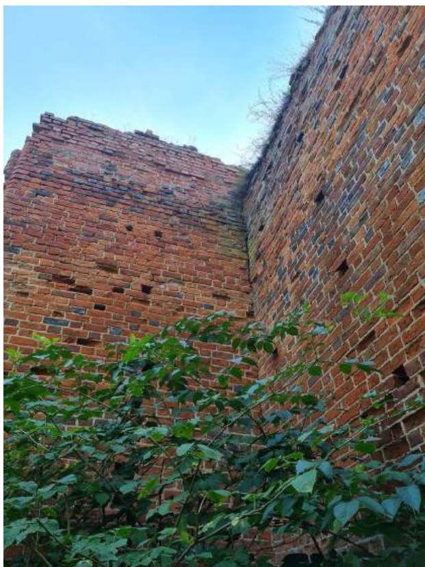
79. Zamek Dybowski. Widoczna szczelina w murze w narożniku między zachodnią ścianą budynku mieszkalnego a dobudowanym do niego północnym murem obwodowym. Stan w sierpniu 2022 r. (Fot. E. Płocińska)
