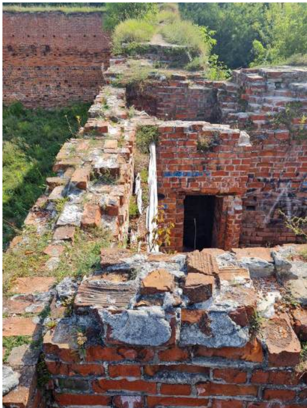
90. Zamek Dybowski. Stan zachowania korony murów. Sierpień 2022 r. (Fot. E. Płocińska)
