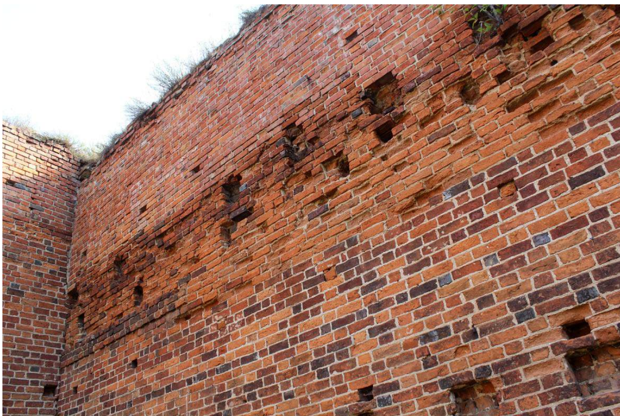
94. Zamek Dybowski. Zniszczenia cegły w obrębie lica murów. Sierpień 2022 r. (Fot. E. Płocińska)
