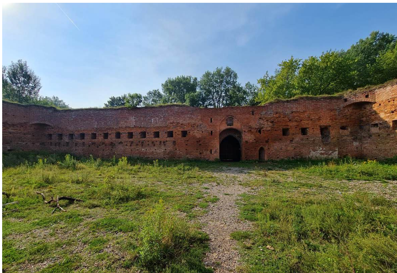
15. Zamek Dybowski. Południowy mur obwodowy. Widok od strony dziedzińca. Stan w sierpniu 2022 r. (Fot. E. Płocińska.)
