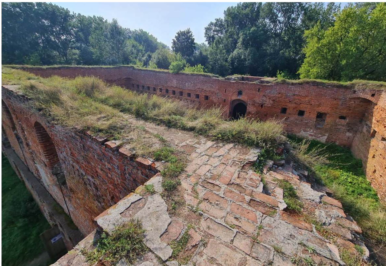
88. Zamek Dybowski. Stan zachowania korony murów. Sierpień 2022 r. (Fot. E. Płocińska)
