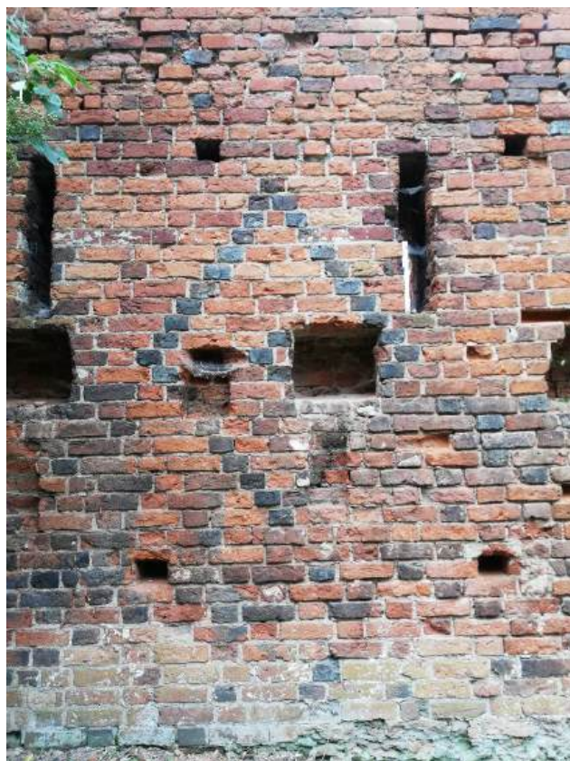
48. Zamek Dybowski. Dekoracja ze zróżnicowanych kolorystycznie cegieł. Mur południowy dziedzińca po stronie wschodniej. Widok od zewnątrz. Stan w sierpniu 2022 r. (Fot. E. Płocińska.)
