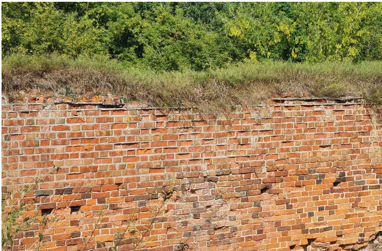
99. Zamek Dybowski. Zniszczenia cegły w obrębie lica murów. Widoczne ubytki lica ceglanego między siatką dobrze zachowanych spoin o zbyt dużej wytrzymałości mechanicznej. Stan w sierpniu 2022 r. (Fot. E. Płocińska)
