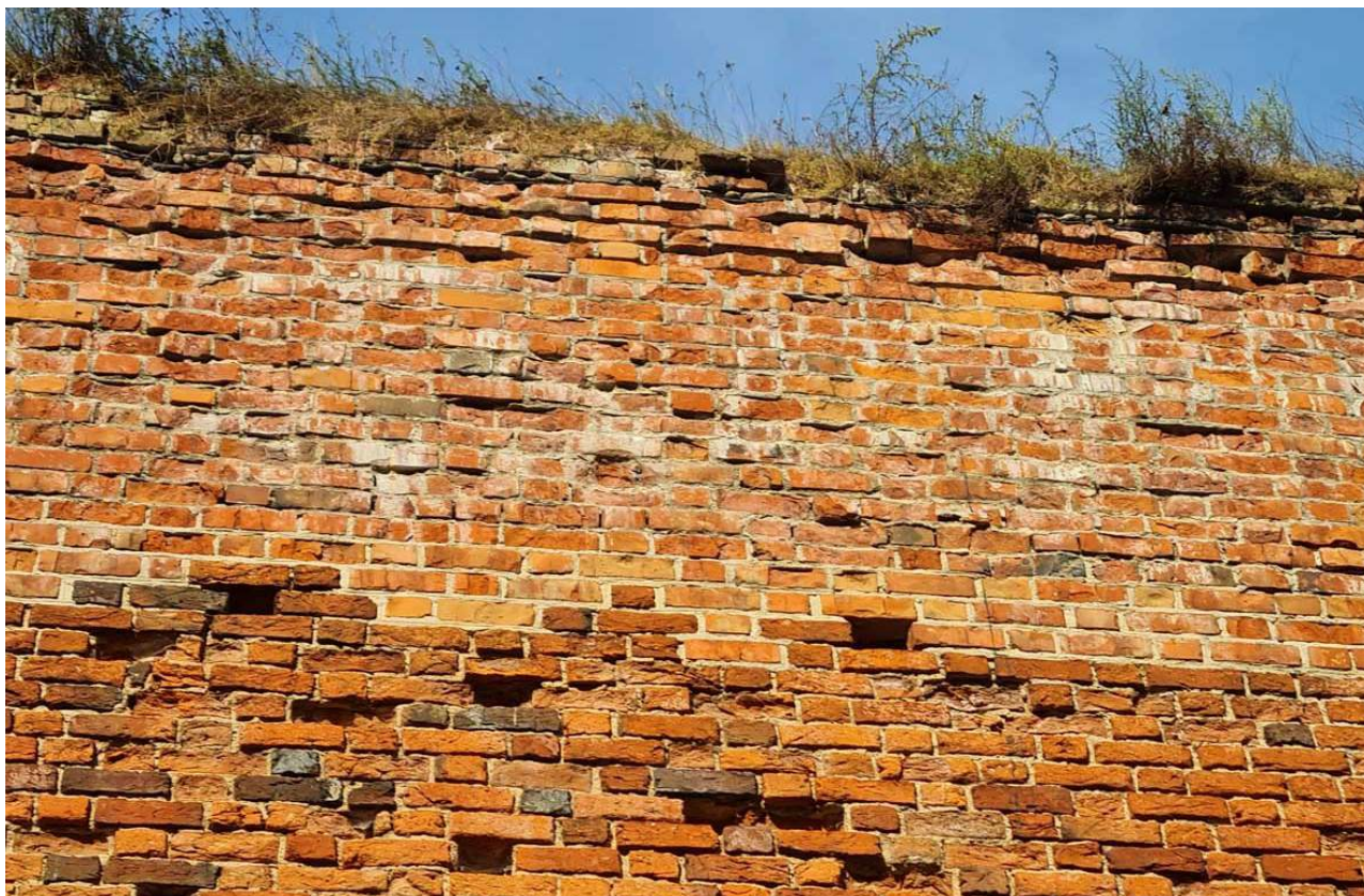
100. Zamek Dybowski. Zniszczenia cegły w obrębie lica murów. Widoczne białe wykwyty będące skutkiem wypłukiwania rozpuszczonych w wodzie składników zapraw. Destrukcja cegieł w partii korony i izolacji poziomej muru. Stan w sierpniu 2022 r. (Fot. E. Płocińska)
