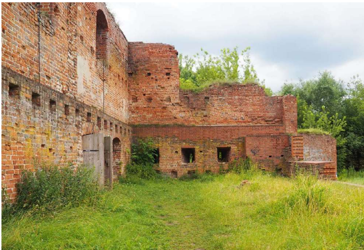
20. Zamek Dybowski. Zachodnia ściana dawnego budynku mieszkalnego. Stan w sierpniu 2022 r. (Fot. P. Kofacz.)
