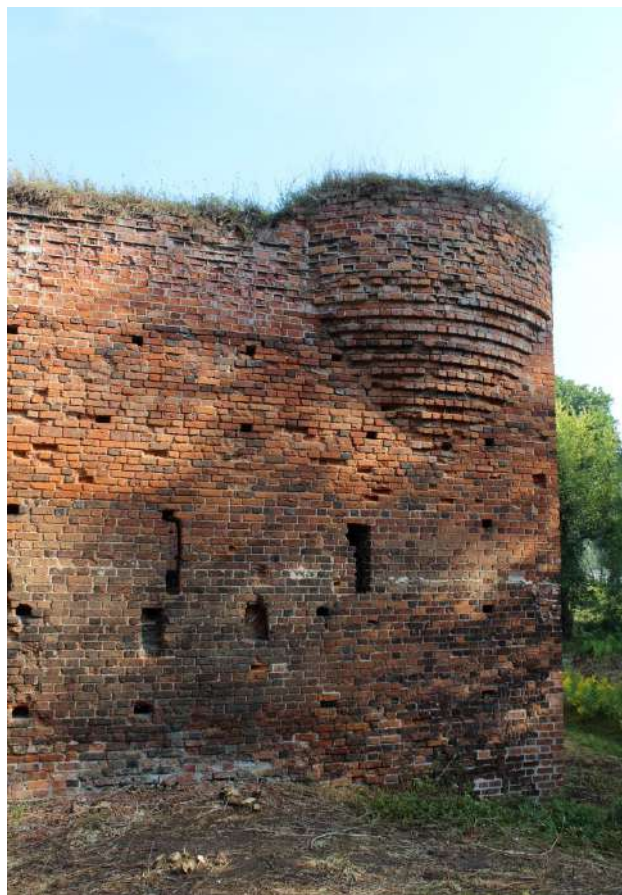
96. Zamek Dybowski. Zniszczenia cegły w obrębie lica murów oraz ciemne nawarstwienia. Sierpień 2022 r. (Fot. E. Płocińska)
