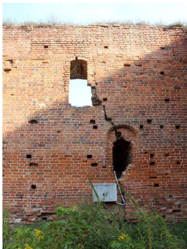
78. Zamek Dybowski. Północna ściana muru obwodowego dziedzica. Widoczna szczelina w murze. Stan w sierpniu 2022 r. (Fot. E. Płocińska)
