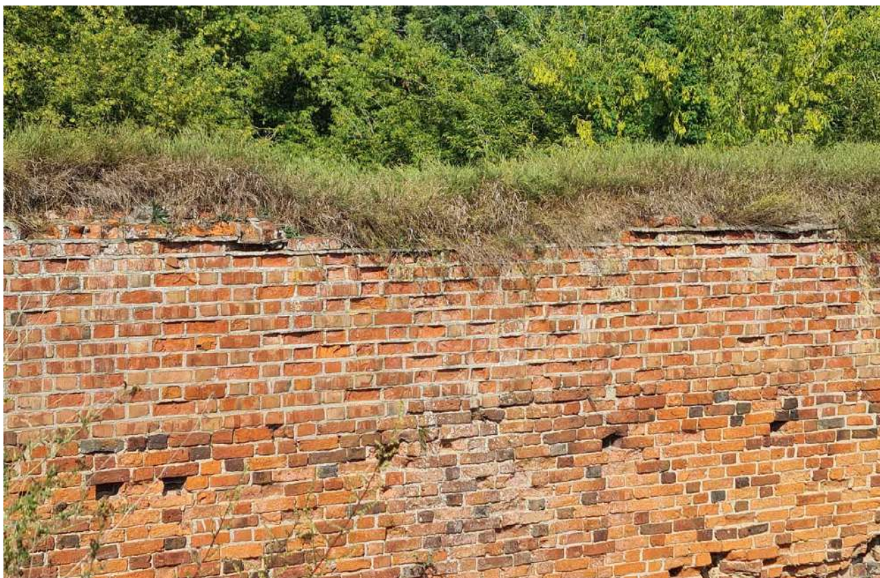
99. Zamek Dybowski. Zniszczenia cegły w obrębie lica murów. Widoczne ubytki lica ceglanego między siatką dobrze zachowanych spoin o zbyt dużej wytrzymałości mechanicznej. Stan w sierpniu 2022 r. (Fot. E. Płocińska)
