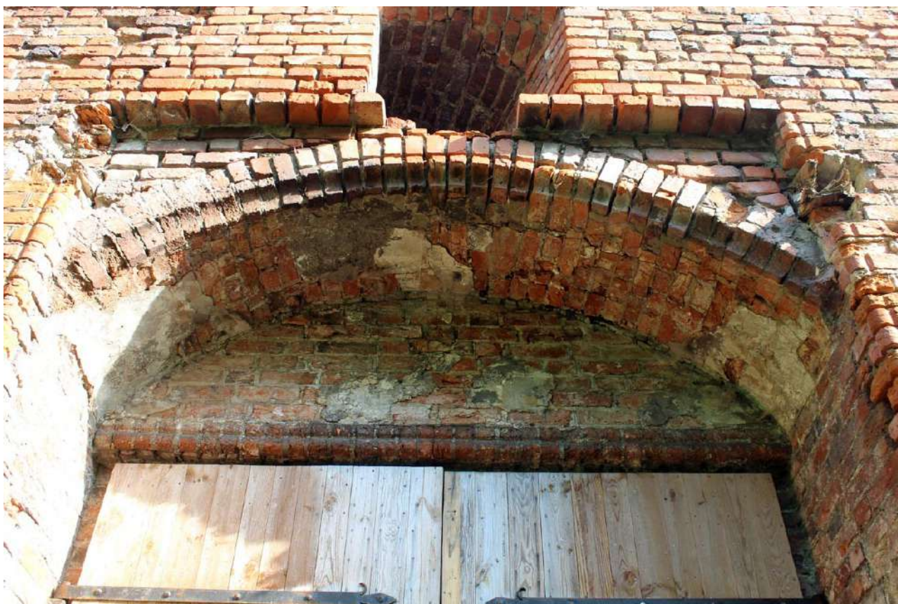
108. Zamek Dybowski. Zniszczenia tynków zabytkowych. Wieża bramna. Stan w sierpniu 2022 r. (Fot. E. Płocińska)
