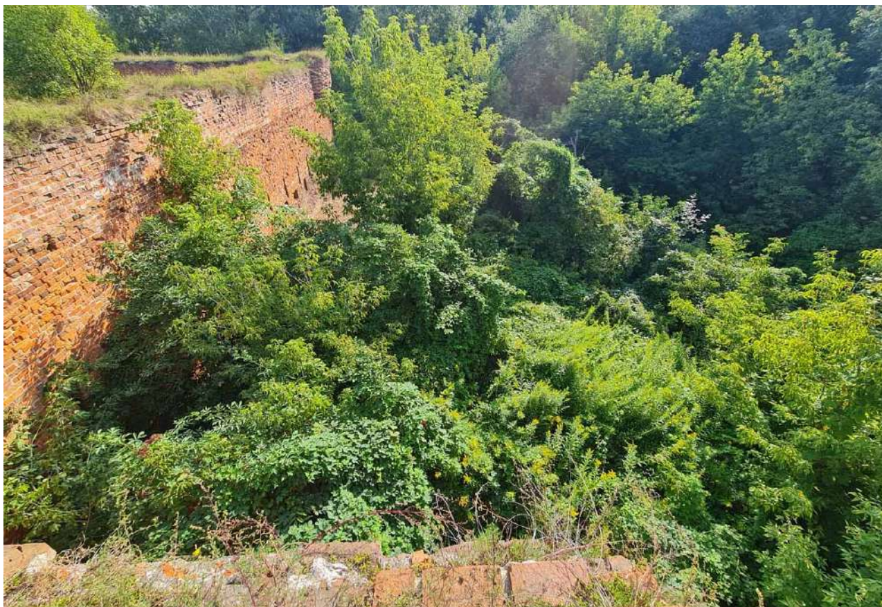
84. Zamek Dybowski. Mur południowy. Gęsta, dzika roślinność porastająca otoczenie zamku. Stan w sierpniu 2022 r. (Fot. E. Płocińska)
