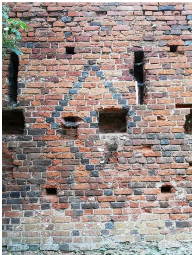
48. Zamek Dybowski. Dekoracja ze zróżnicowanych kolorystycznie cegieł. Mur południowy dziedzińca po stronie wschodniej. Widok od zewnątrz. Stan w sierpniu 2022 r. (Fot. E. Płocińska.)
