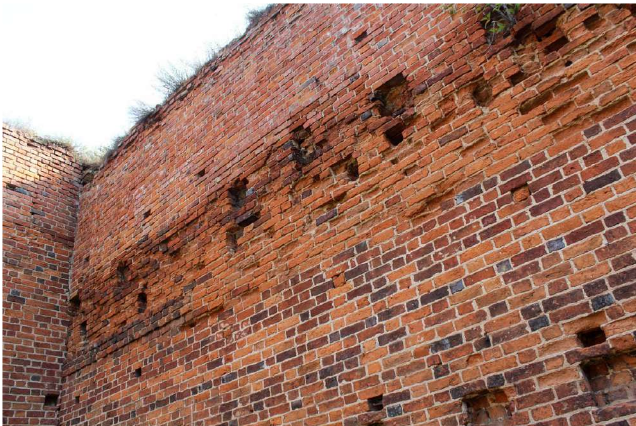
94. Zamek Dybowski. Zniszczenia cegły w obrębie lica murów. Sierpień 2022 r. (Fot. E. Płocińska)
