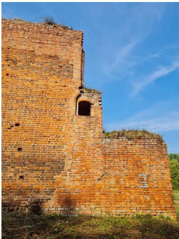
77. Zamek Dybowski. Wschodnia ściana dawnego budynku mieszkalnego. Widoczna szczelina w murze. Stan w sierpniu 2022 r. (Fot. E. Płocińska)
