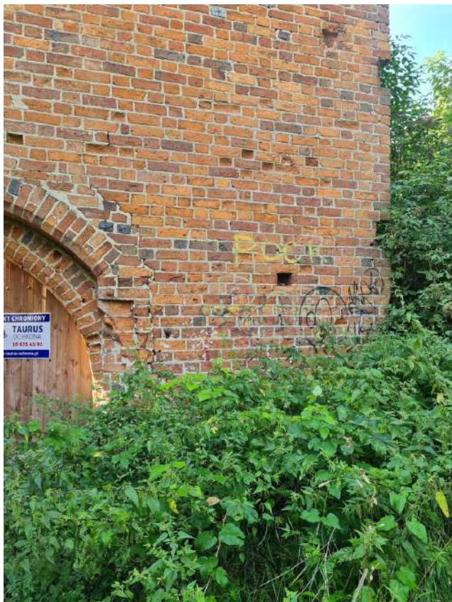
112. Zamek Dybowski. Zniszczenia lica ceglanego wskutek aktów wandalizmu. Stan w sierpniu 2022 r. (Fot. E. Płocińska)
