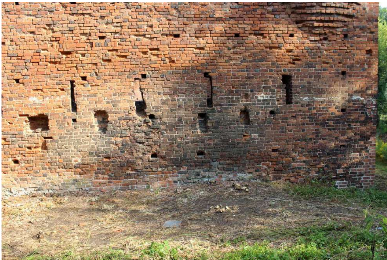
80. Zamek Dybowski. Wschodni odcinek muru południowego. Widoczna strefa podciągania kapilarnego wody z gruntu. Stan w sierpniu 2022 r. (Fot. E. Płocińska)
