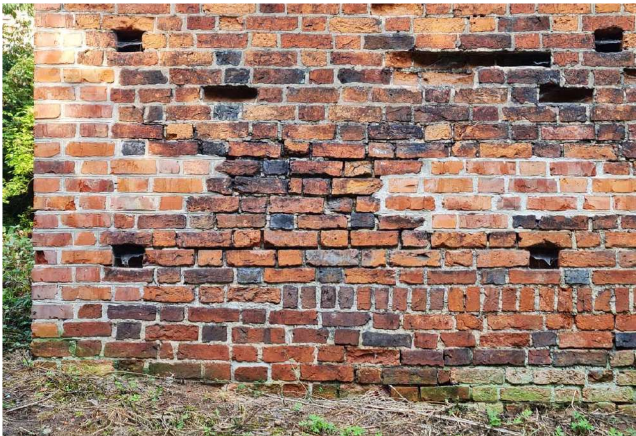
104. Zamek Dybowski. Zniszczenia cegły historycznej i współczesnej. Niewłaściwe cegły i spoiny użyte do przemurowań. Stan w sierpniu 2022 r. (Fot. E. Płocińska)
