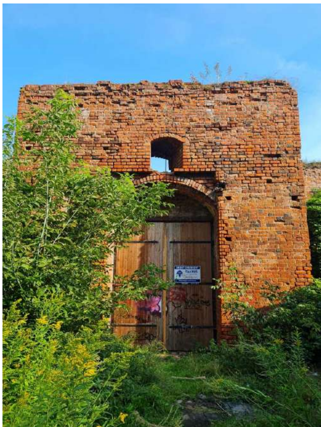
24. Zamek Dybowski. Zachowany przejazd wieży bramnej. Widok od strony północnej. Stan w sierpniu 2022 r. (Fot. E. Płocińska.)
