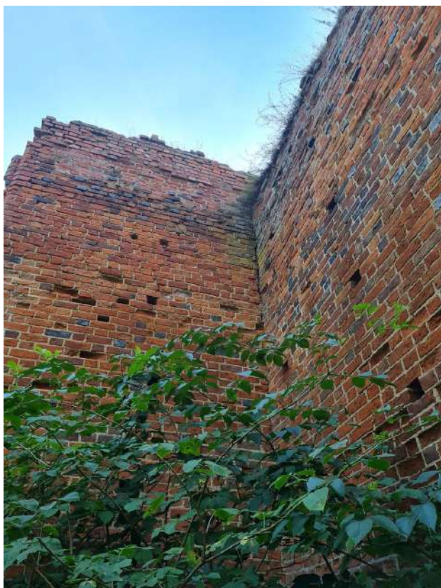
79. Zamek Dybowski. Widoczna szczelina w murze w narożniku między zachodnią ścianą budynku mieszkalnego a dobudowanym do niego północnym murem obwodowym. Stan w sierpniu 2022 r. (Fot. E. Płocińska)
