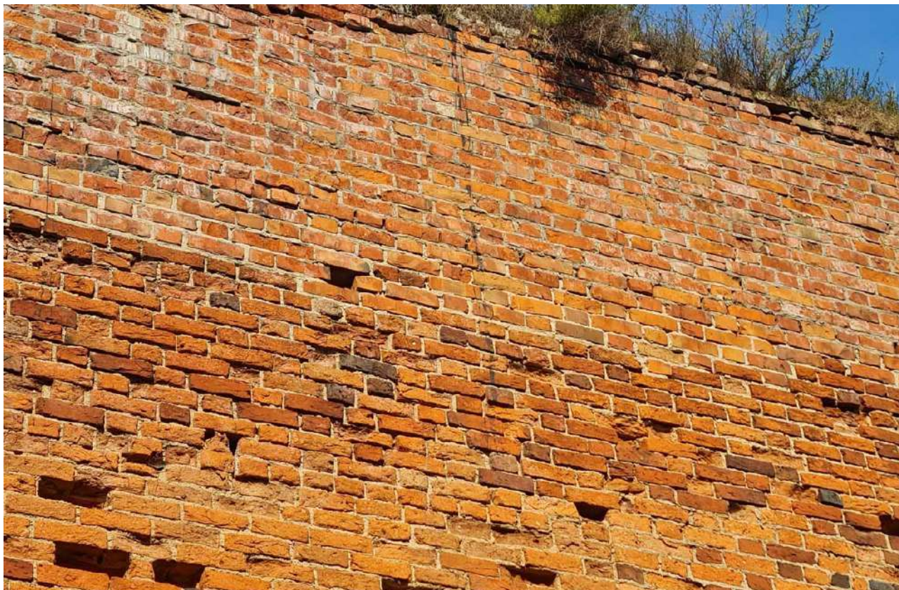
98. Zamek Dybowski. Zniszczenia cegły w obrębie lica murów. Widoczne białe wykwyty będące skutkiem wypłukiwania rozpuszczonych w wodzie składników zapraw oraz zalanie smołą z miejsca układania warstwy papy jako izolacji poziomej korony murów. Stan w sierpniu 2022 r. (Fot. E. Płocińska)
