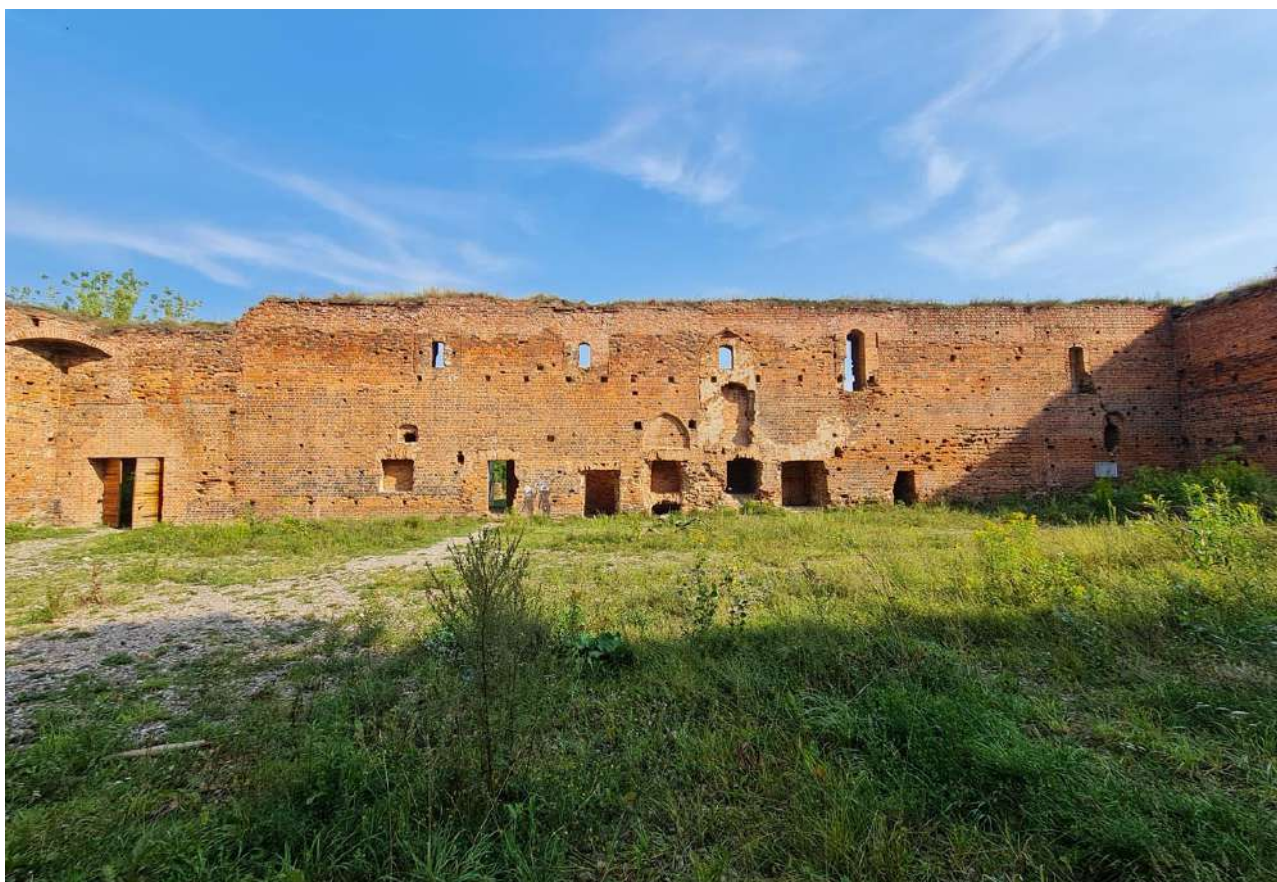
9. Zamek Dybowski. Północny mur obwodowy. Widok od dziedzińca. Stan w sierpniu 2022 r. (Fot. E. Płocińska.)
