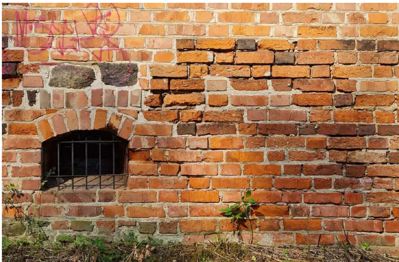
105. Zamek Dybowski. Zniszczenia cegły historycznej i współczesnej. Niewłaściwe cegły i spoiny użyte do przemurowań. Stan w sierpniu 2022 r. (Fot. E. Płocińska)
