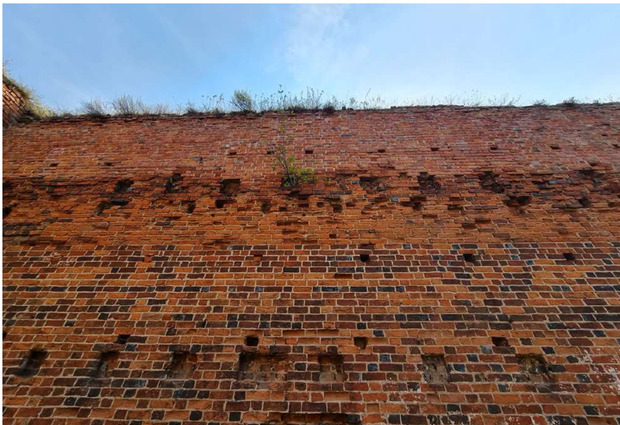
93. Zamek Dybowski. Zniszczenia cegły w obrębie lica murów. Sierpień 2022 r. (Fot. E. Płocińska)
