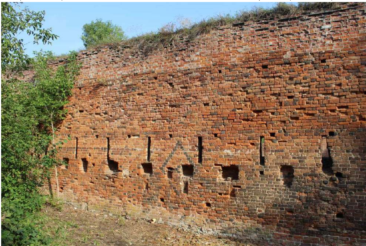
97. Zamek Dybowski. Zniszczenia cegły w obrębie lica murów oraz ciemne nawarstwienia. Sierpień 2022 r. (Fot. E. Płocińska)
