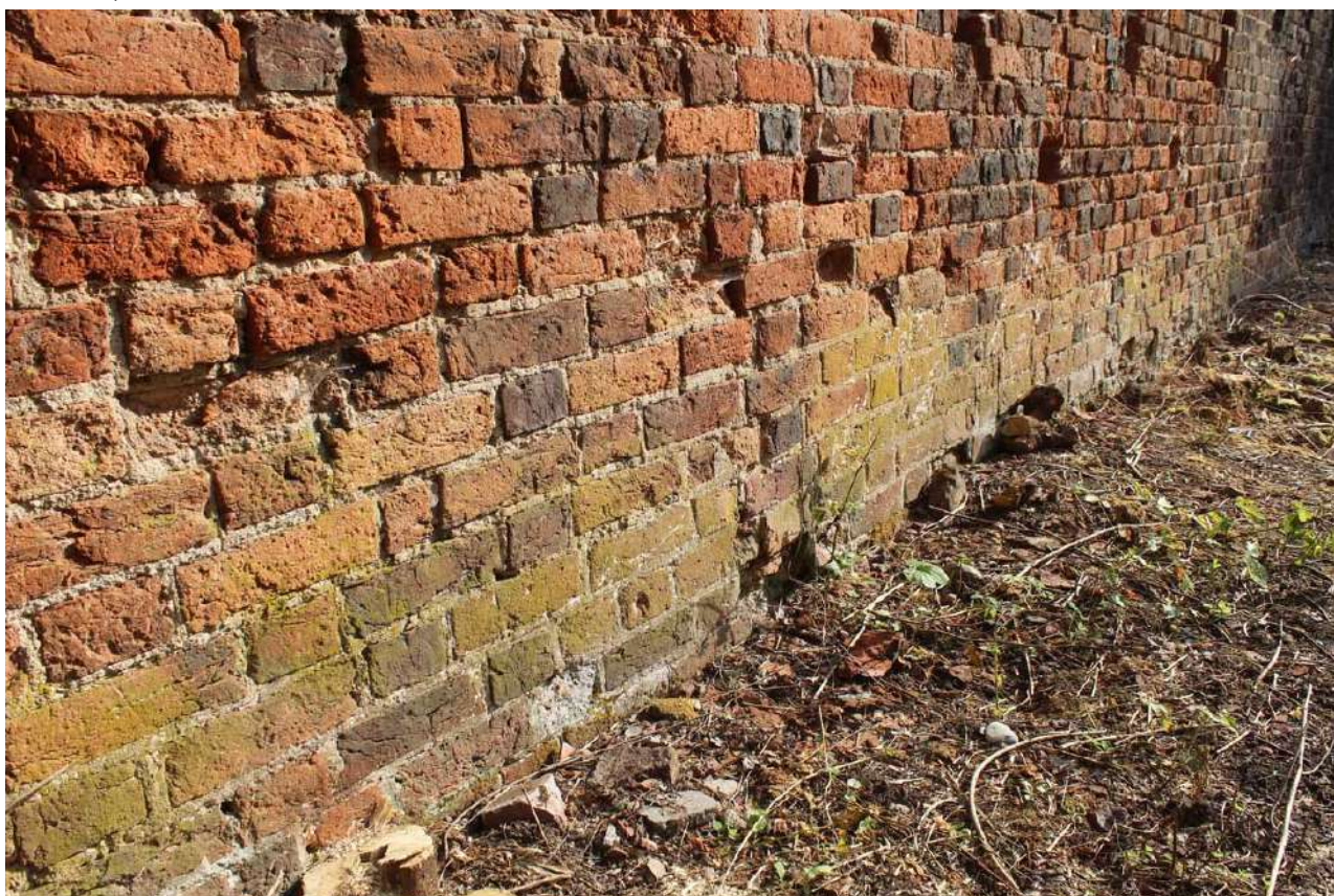
81. Zamek Dybowski. Wschodni odcinek muru południowego. Ślady infekcji biologicznej w partii przyziemia. Stan w sierpniu 2022 r. (Fot. E. Płocińska)
