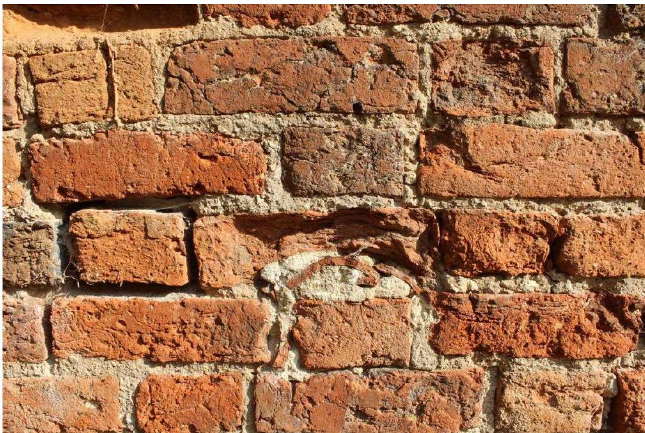
107. Zamek Dybowski. Zniszczenia cegły historycznej. Stan w sierpniu 2022 r. (Fot. E. Płocińska)
